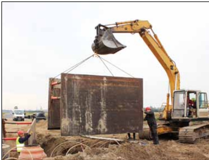
Uzsākta ūdensapgādes un kanalizācijas tīklu būvniecība no Olaines pilsētas līdz apdzīvotai vietai Grēnes
